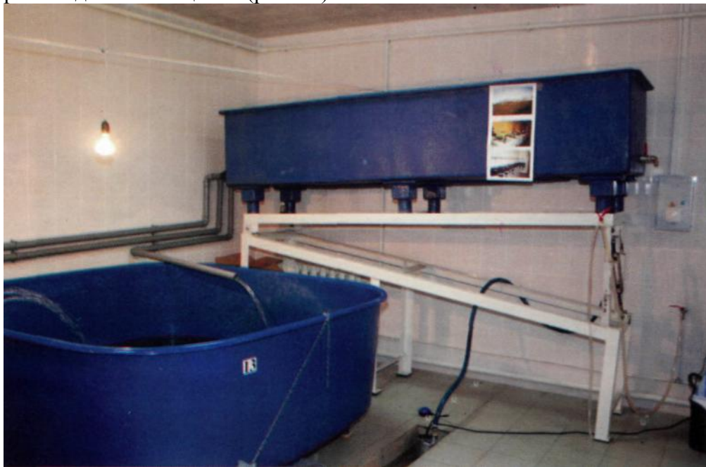
Рис. 32. Основные компоненты установки замкнутого водообеспечения
