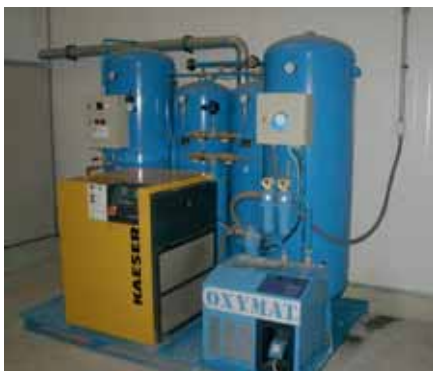
Иллюстрация 5.2 Генератор кислорода. Необходим контроль и уход за специальным оборудованием.
