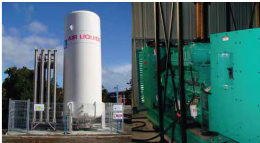
Иллюстрация 2.19 Кислородный резервуар и аварийный генератор.
